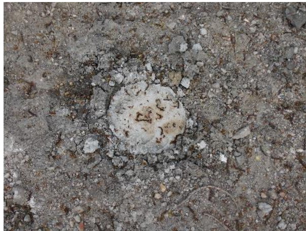
Neutralisation du piézomètre Pz2 par injection d'un mélange de coulis de ciment/bentonite
